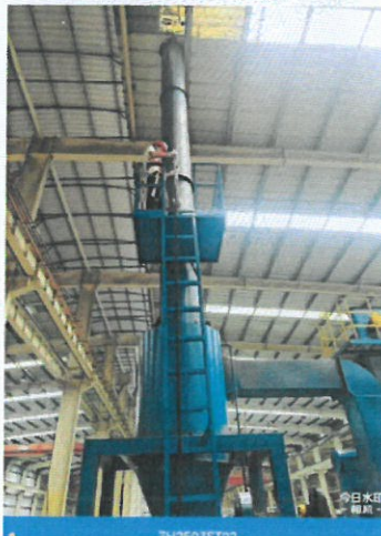
ZH2507ST02 项目名称: 晟通科技集团有限公司自行 监测项目 监测点位: 制乳除尘排气管DA009 经度: 112.833696°E 纬度: 28.324053°N
